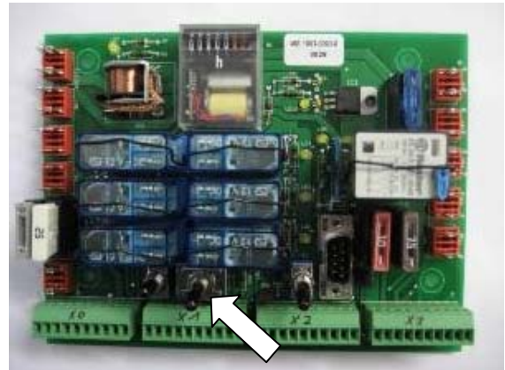
Abb. 246: Platine im Schaltschrank
