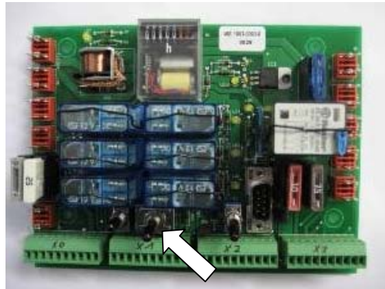
Abb. 248: Platine im Schaltschrank
